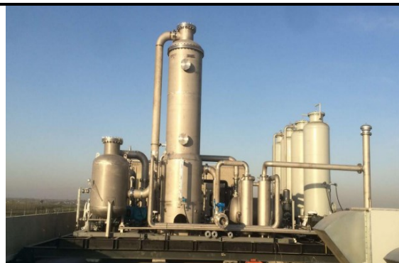
山东济宁某制药厂二氯甲烷尾气回收与处理，吸收+冷凝+膜+吸附工艺，处理规模：1000m 3 /h
