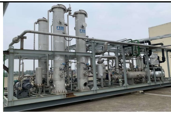
浙江绍兴某制药厂二氯甲烷尾气回收与处理，冷凝+膜+吸附工艺，处理规模：500m 3 /h
