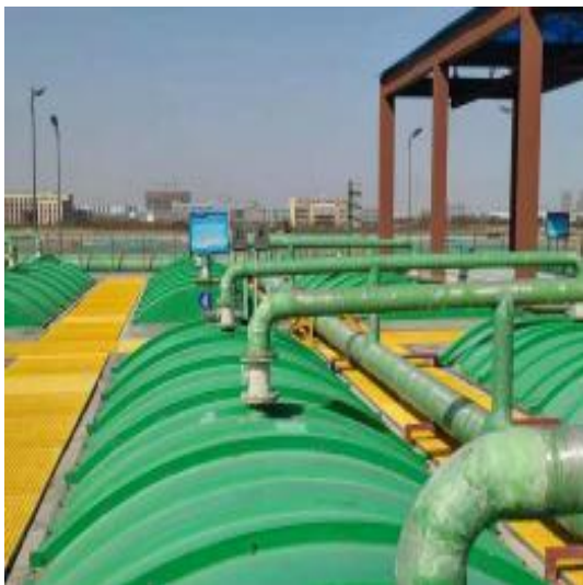
废水处理设施 5：好氧池
