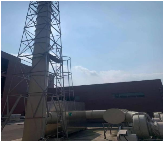
危废暂存间 1 废气排放口
