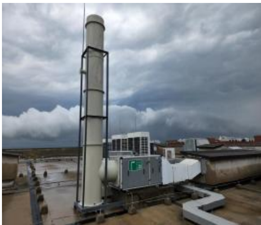
W 栋北废气排放口
