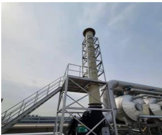
J 栋废气排放口
