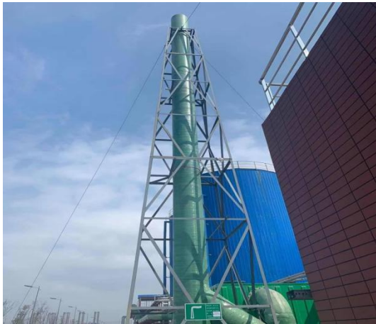
综合污水站废气排放口
