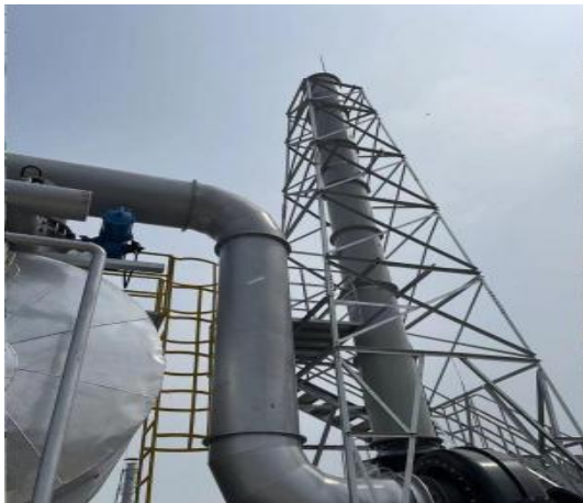
K 栋西废气排放口
