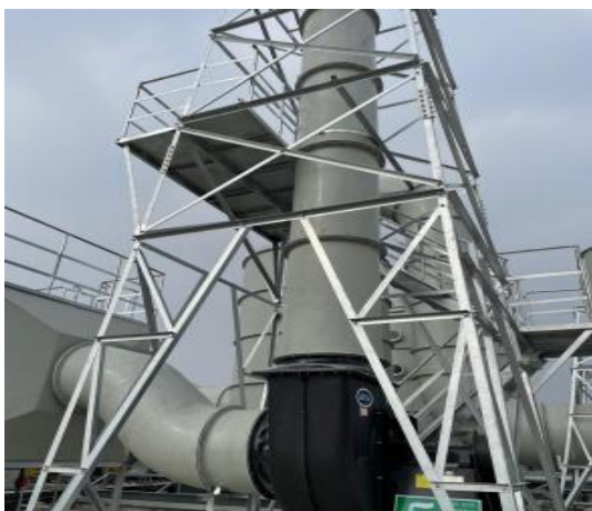
研发车间 B2 废气排放口
