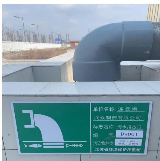
污水排放口标示牌
