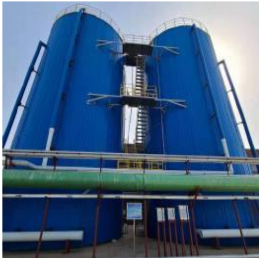
废水处理设施 3：厌氧池
