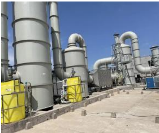
H 栋东废气排放口
