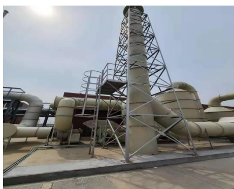
罐区 1+危废暂存间 2 废气排放口
