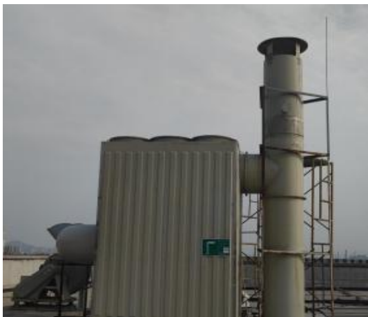
W 栋南废气排放口
