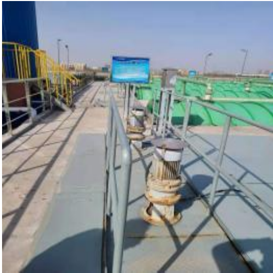
废水处理设施 1：中和槽
