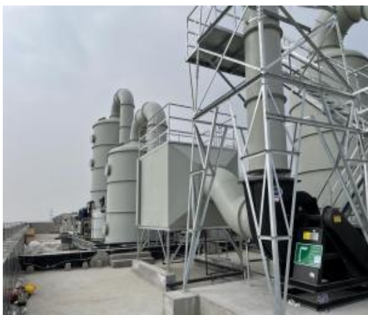
研发车间 B1 废气排放口
