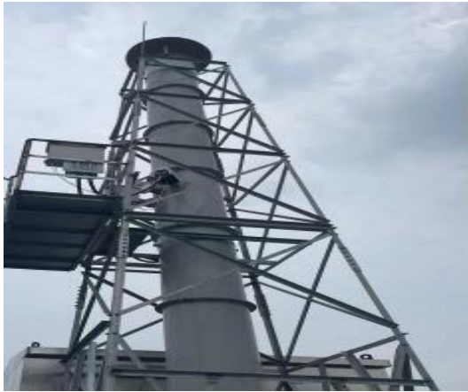
3H 栋西废气排放口
